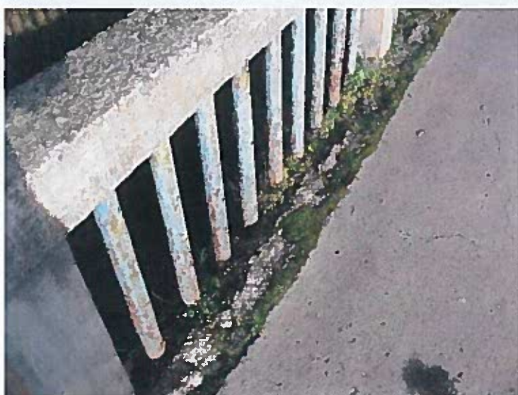
Degradace římsy, koroze svislé výplně zábradlí
